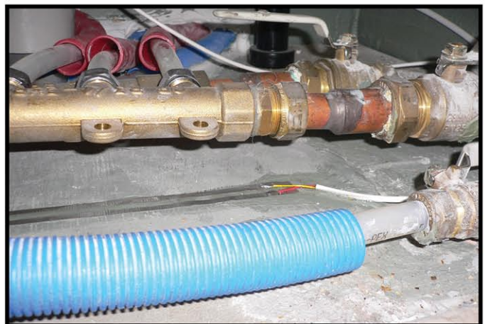
Kuvassa jakotukin alle asennettu vesivuotoanturi
